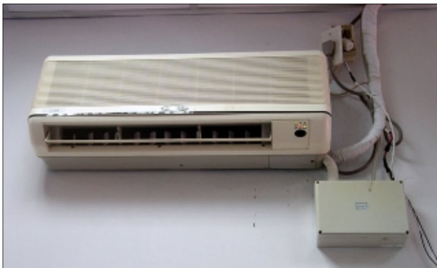
[圖 7] 加入電壓與電流監視的冷氣機系統，多了四條電力信號線進入旗威科技的 PWR-H 上。我們也發現冷氣機運轉時，溫度設定不要太低，免得壓縮機一直運轉而浪費過多的能源。
